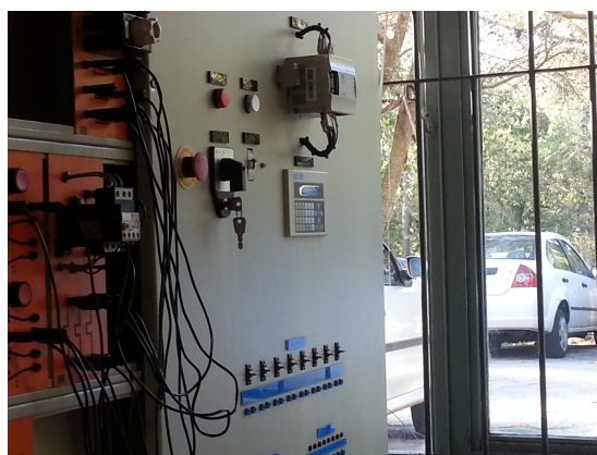
Figura 3: Identificação insuficiente da bancada energizada
