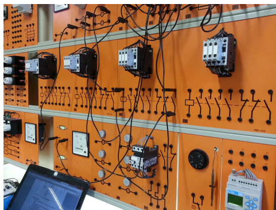
Figura 2: Falta de identificação em cada placa
