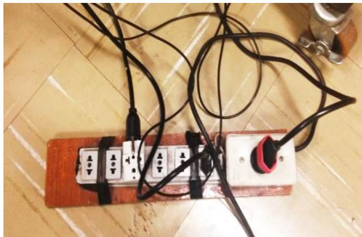
Figura 15 - Tomadas improvisadas. Fonte: As autoras (2014)
