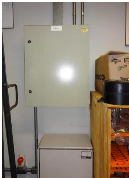
Figura 5 - Quadro de distribuição com acesso obstruído. Fonte: As autoras (2014)
