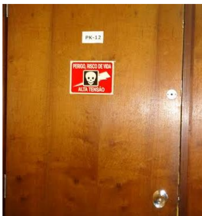
Figura 4 - Identificação inadequada da área energizada. Fonte: As autoras (2014)
