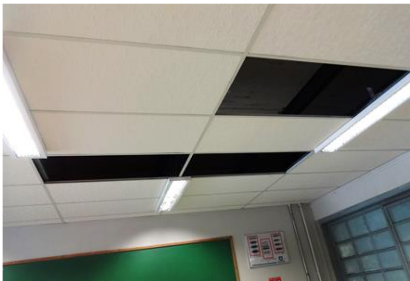
Figura 22 - Placas foram retiradas por problema de goteiras. Fonte: As autoras (2014)
