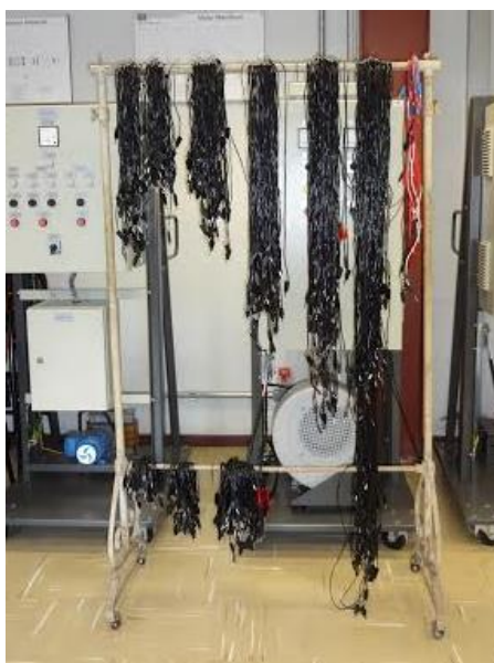
Figura 10 - Cabos do laboratório de Eletrotécnica PK-12. Fonte: As autoras (2014)
