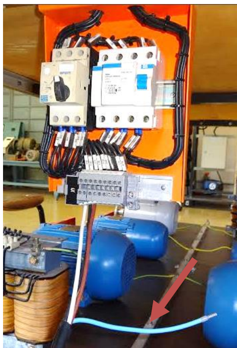
Figura 13 - Disjuntor DDR com neutro desconectado. Fonte: As autoras (2014)
