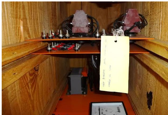
Figura 19 - Placas com defeitos. Fonte: As autoras (2014)
