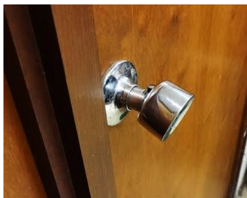
Figura 21 - Maçaneta da porta de acesso quebrada. Fonte: As autoras (2014)
