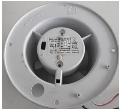
FIGURA 22 - EXAUSTOR DE BANHEIRO
