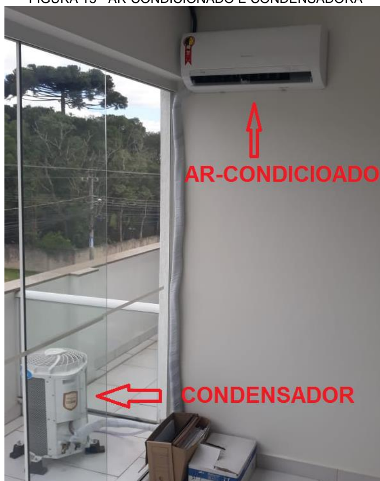
FIGURA 15 - AR-CONDICIONADO E CONDENSADORA
