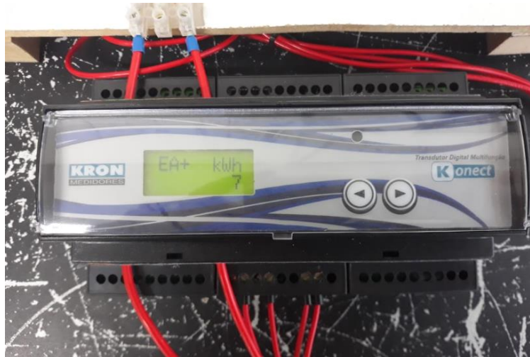
FIGURA 12 - MEDIDOR DE ENERGIA
