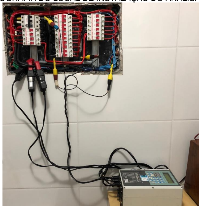
FIGURA 26 - FOTOGRAFIA DO LOCAL DE INSTALAÇÃO DO ANALISADOR DE ENERGIA
