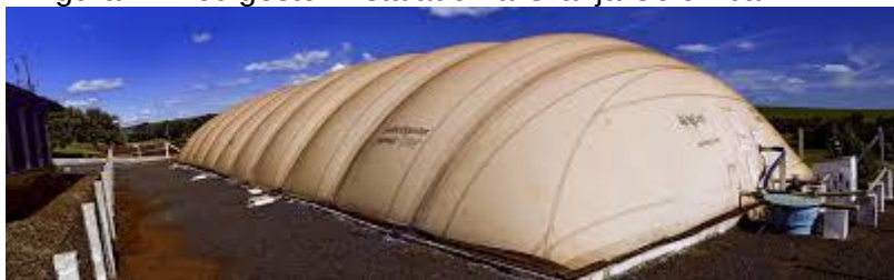
Figura 7: Biodigestor instalado na Granja Colombari
